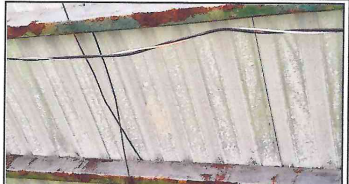
Foto 2: El 70% DE LAS COSTANERAS ESTÁN AFECTADAS POR ESTA CORROSIÓN.
