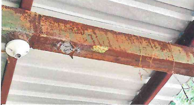
Foto 1: COSTANERAS EN MAL ESTADO, POR EL FENOMENO NATURAL, CORROSIVO DEL AZUFRE, EN ALDEA IXPACO.
